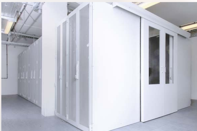
Serwery firmy Manner zostały umieszczone w 14 szafach TS IT firmy Rittal. Ustawione w dwóch przeciwległych szeregach tworzą zimną strefę.
