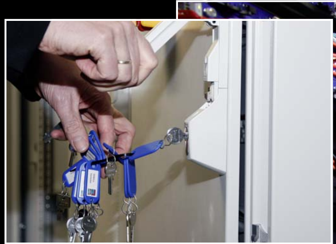
Technikbereich RiMatrix S Single 6
