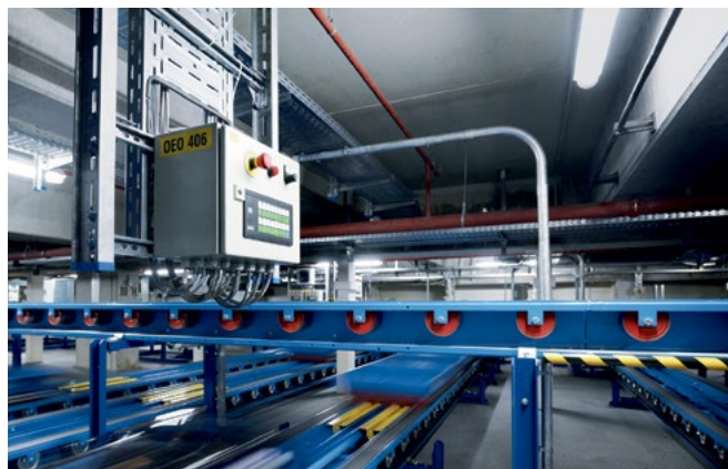
В корпусе Rittal размещена техника автоматического управления конвейером для багажа в аэропорту Франкфурта.
