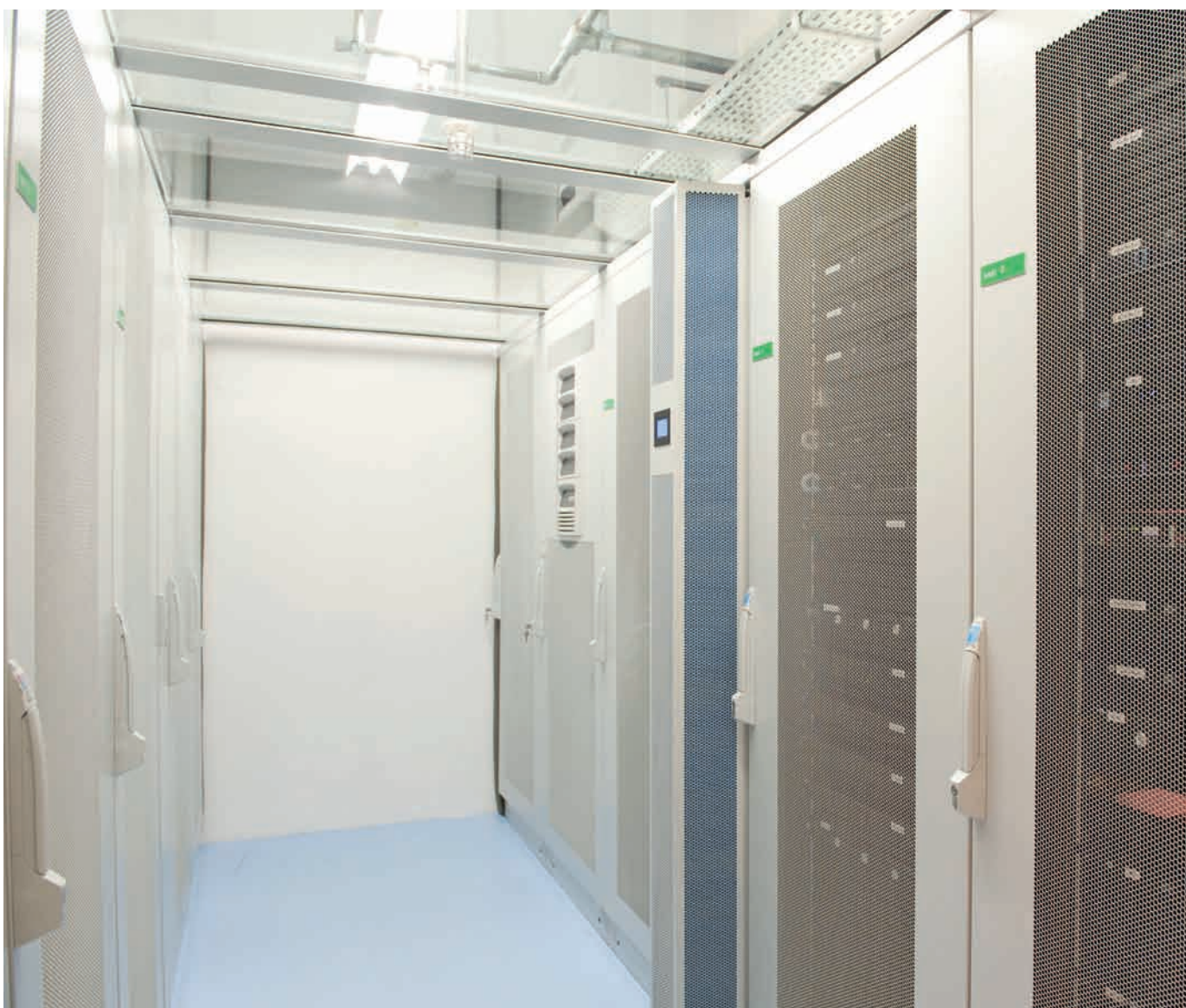
De volledig afgesloten koude gang.
