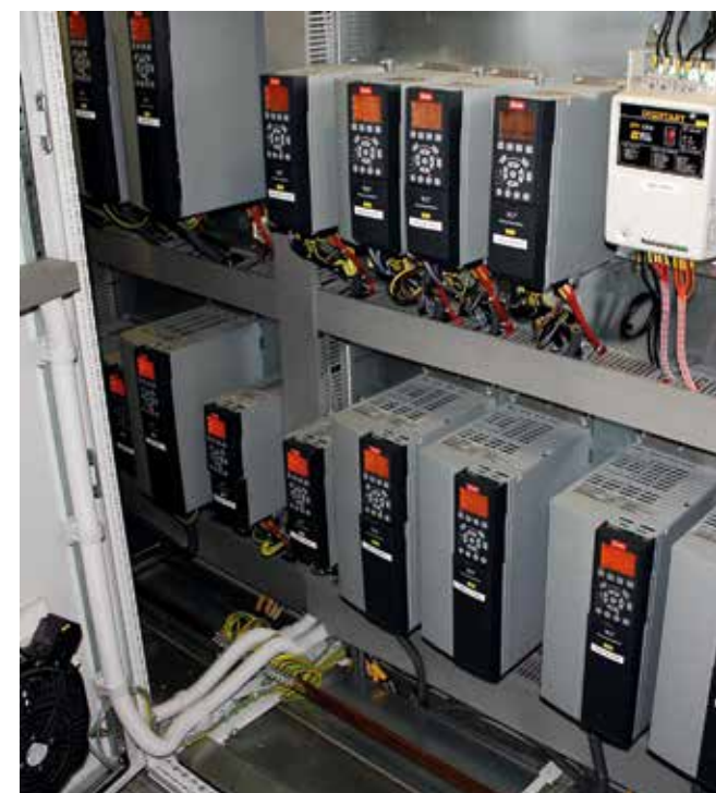
"Panels and Installations" bouwt automatiseringsborden en vermogensborden tot 3200 ampère. Alles wordt meestal in hun eigen atelier opgebouwd. Ze beschikken nu al over 800 m² werkruimte en hebben de mogelijkheid om te verdubbelen tot 1600 m².
